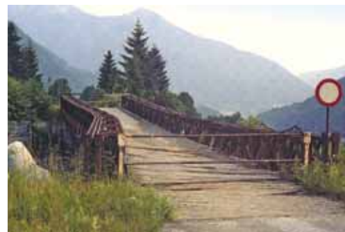
Fig. 187 – Il ponte in ferro che attraversava il Rio Moscardo, quasi all'altezza del fondovalle, nel 1976 ricevette una spallata poderosa portata da una colata (lava torrentizia) scesa dal Rio Moscardo. Fu l'inizio della sua fine. Di lì a pochi mesi (v. fotografia successiva) un secondo evento, ancor più catastrofico del primo, sradicò la struttura spostandola a valle. (Foto Circolo Culturale Ricreativo Cleulis).
