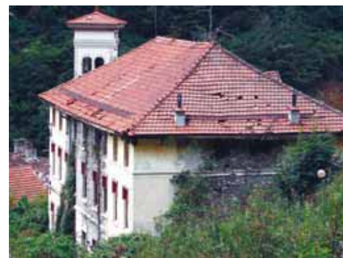
Fig. 3 – La 'vecchia' Scuola Elementare di Timau, così come si presenta oggi, abbandonata agli abusi delle intemperie.
