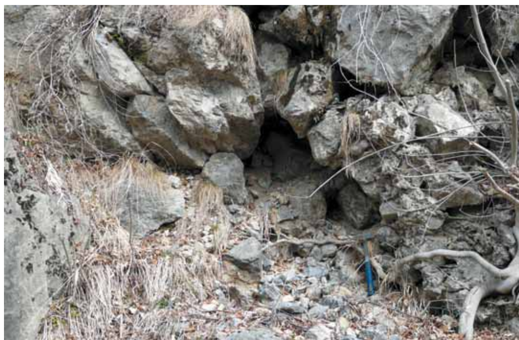
Fig. 124 – Particolare della morena del Fontanone, deposito tardo-glaciale. È visibile in corrispondenza di un cedimento del muro di contenimento stradale, un centinaio di metri a valle della omonima sorgente carsica.
