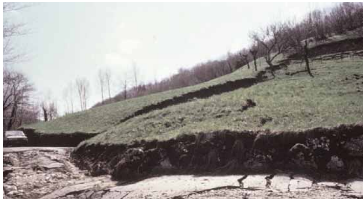
Fig. 285 - Questo movimento franoso è solo all'inizio. Si tratta di un incipiente smottamento che sta coinvolgendo, con effetti evidenti, una coltre di materiali sciolti. L'evoluzione del processo di dissesto, se non bloccata da interventi di sistemazione, porterà alla formazione di una nicchia di frana della quale fin d'ora è possibile riconoscere parte dell'orlo sommitale in alto a destra.
